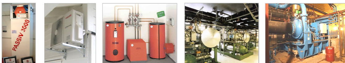
Figur 4 Eksempler på norske varmepumpeanlegg i ulike kapasitetsklasser, fra ca. 1,5 kW (venstre) til 28 MW.
